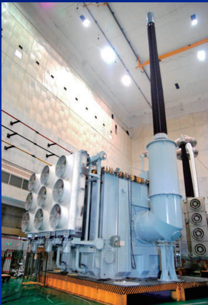
西安西电 1000kV 260MVA 发电机变压器 ▶
